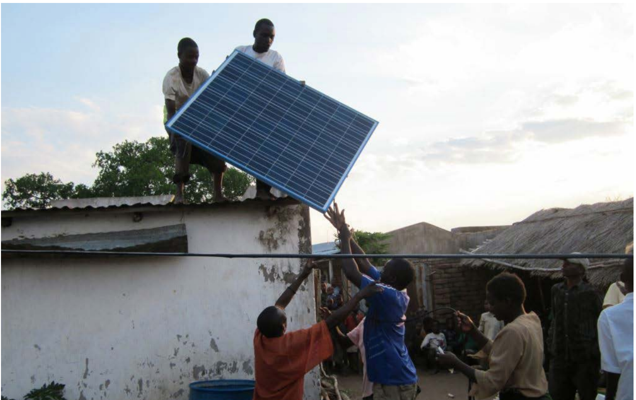
VOA, Installation d'un panneau solaire individuel , Rwanda, 2014, disponible à l'URL : http://www.voaafrique.com/a/entree-en-production-dune-vaste-centrale-solaire-au-rwanda/2451892.html
